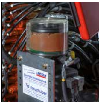
Mengengesteuerte Zentralschmieranlage mit Leerstandsmeldung
